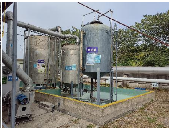
焚烧锅炉储罐
