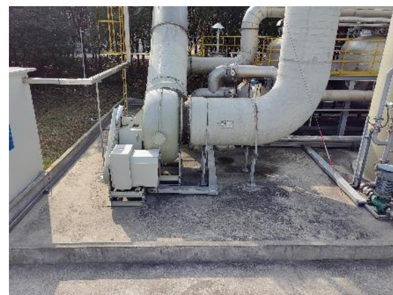
废气处理装置
